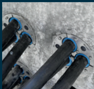
Câbles d'alimentation HT
