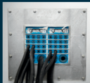
Câbles de contrôle et d'instrumentation
