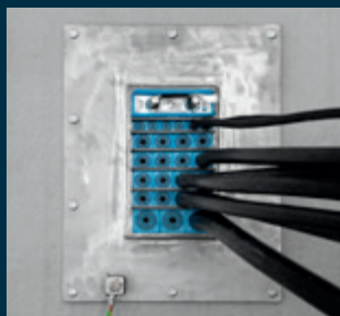
Câbles d'alimentation BT et MT
